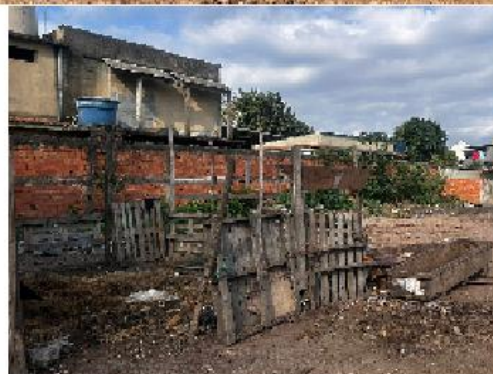
Figura 03 e 04: Instalações de estruturas de madeira ao lado da ruína. Fonte: Inepac.
